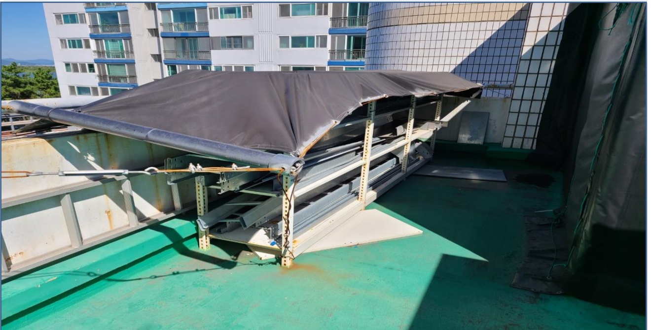
자재보관 창고5(배관 및 트레이 부속자재)
